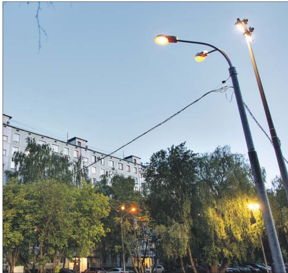
Фонари освещают площадку всю ночь
