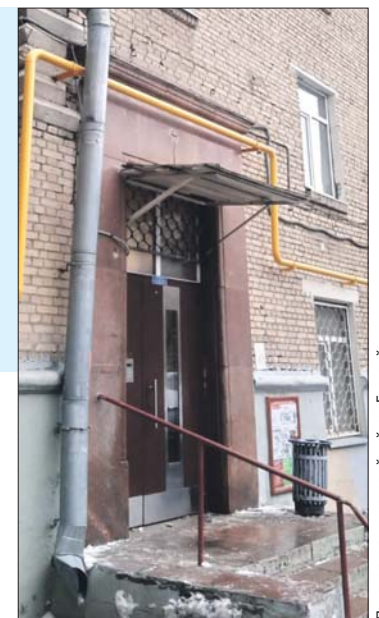
Козырёк пострадал при очистке снега, но теперь опять как новенький
