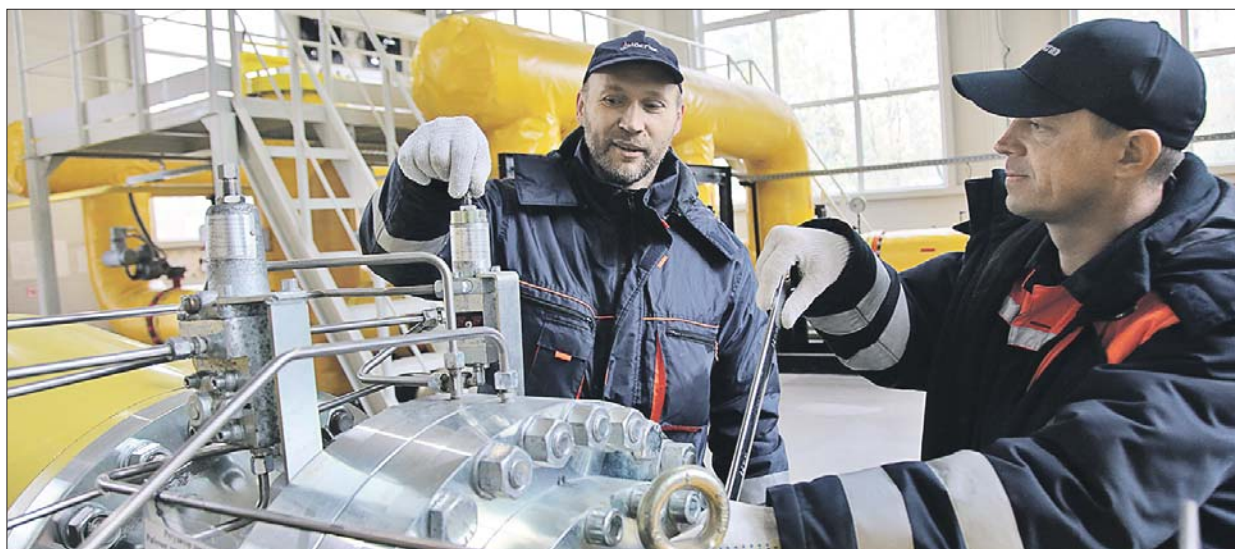
Благодаря автоматике осмотр теперь нужен раз в месяц
