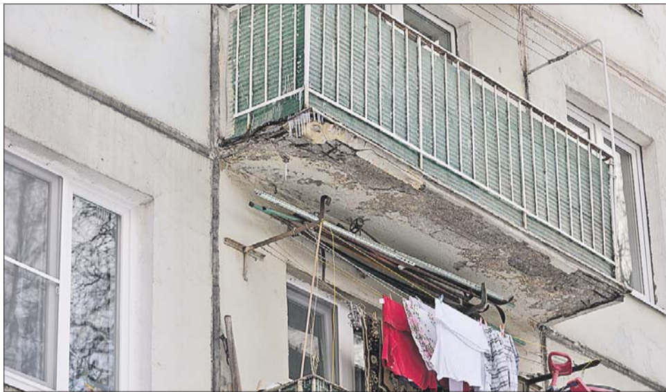
В одной из пятиэтажек в Кузьминках (ЮВАО) идёт разрушение бетона балконной плиты
